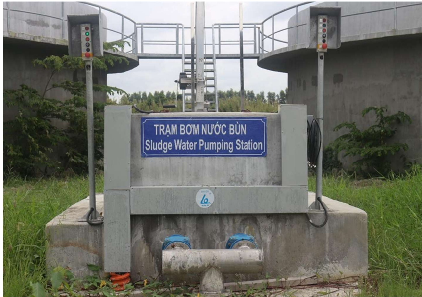
Hình 11 Trạm bơm nước bùn
