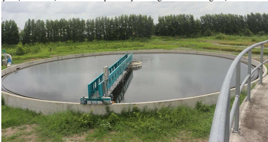
Hình 7 Bể lắng thứ cấp
