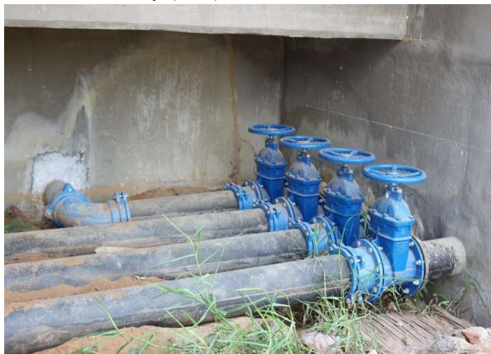
Hình 9 Trạm bơm bùn vận hành theo chế độ tay
