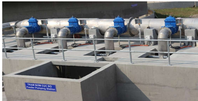
Hình 5 Trạm bơm cục bộ
