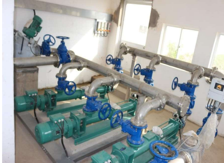
Hình 8 Trạm bơm bùn
